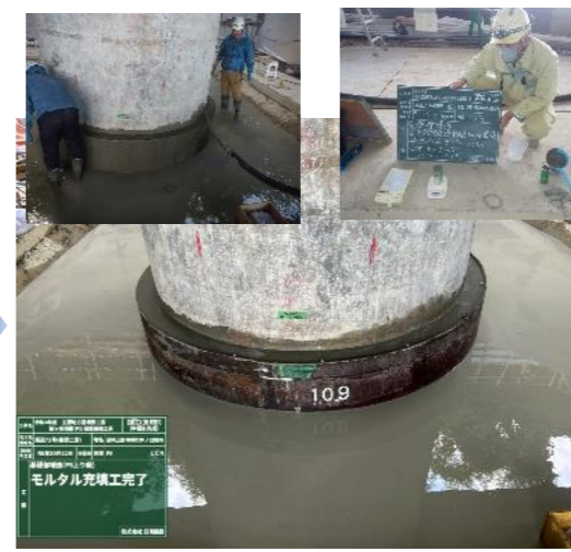
【モルタル充填完了】R5. 10. 11 不純物混じりのモルタルを取り除き比重を確認して完了。
