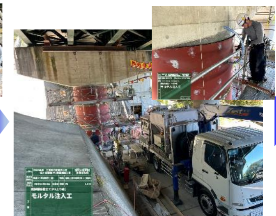
【モルタル注入】R5. 10. 30 モルタル供給システム車により、水・粉体の量を管理しながら、モルタルを注入。
