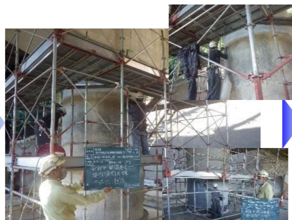
【橋脚部補強工】 足場を設置し、素地調整(サンダーケツ)を行い、無収縮モルタルの品質を確保する為吸出し防止材と橋脚に塗布。 R5. 10. 16~10. 17
