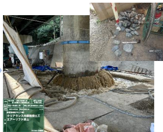
【クリアランス内排土工】 深さを確認しながら圧縮空気を送り排土を繰り返します。
