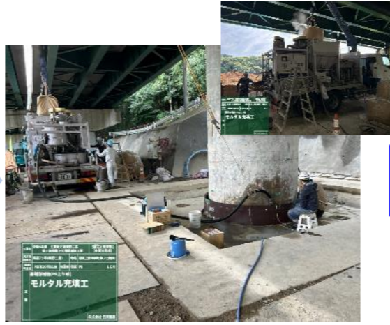
【モルタル充填工】R5. 10. 11 モルタル供給システム車により、水・粉体の量を管理しながら、モルタルを充填します。
